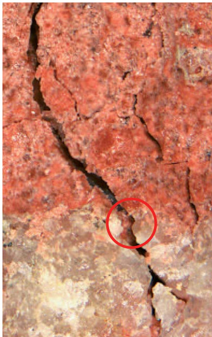
Статические трещины в бетоне
